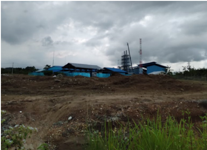
Gambar 39. Proyek pembangunan PLTMG Luwuk yang mangkrak di Desa Nonong
